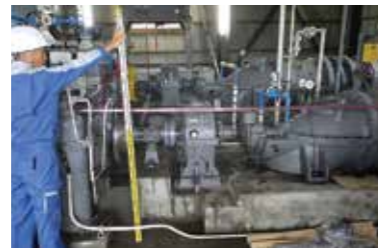
1m以上冠水した機械設備を調査
